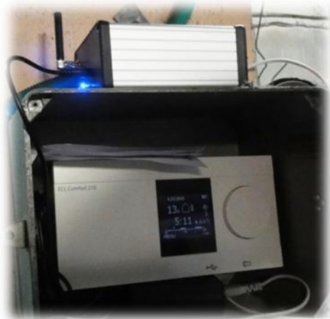
Монтирания компонент на система в ОУ „Г.Бенковски“ - Бургас
